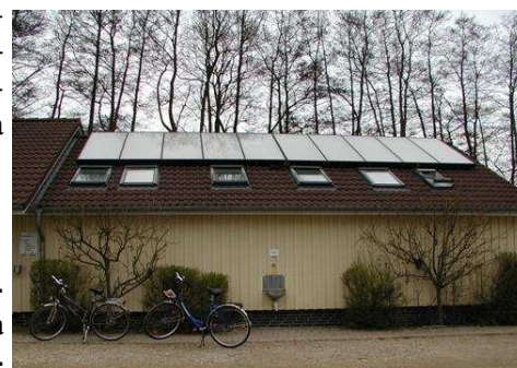
Widok na instalację słoneczną
